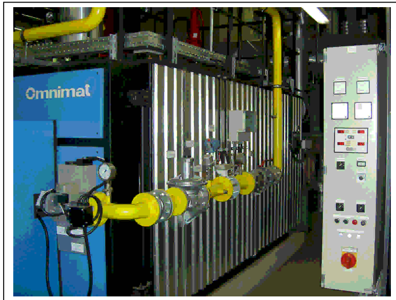
Kessel 2 Wärmeversorgungsanlage NDR Lokstedt (Gesamtleistung 9,5 MW)
